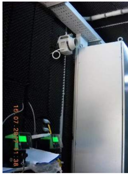
Φώτο 6.6: Ηχομονωτικά υλικά μονάδας αφαλάτωσης εντός του container
