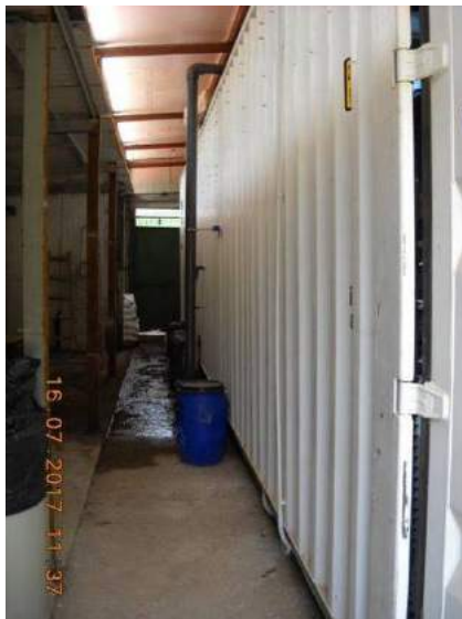
Φώτο 6.5: Μονάδα αφαλάτωσης σε ηχομονωτικό κλωβό και εντός κτηρίου
