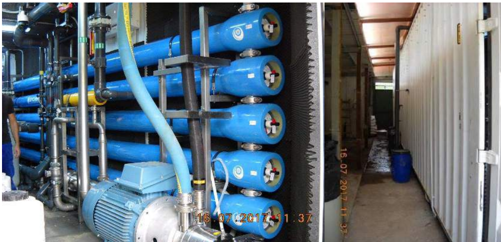
Φώτο 10-13 έως Φώτο 10-15: Νέα αφαλάτωση ξενοδοχείου εντός ηχομονωμένου container το οποίο έχει τοποθετηθεί εντός κλειστού κτηρίου.
