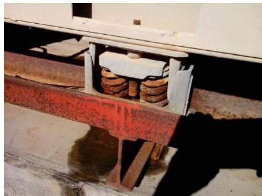
Φώτο 6.2: Σύστημα ανάρτησης πύργου ψύξης
