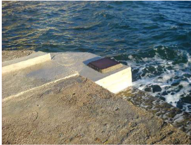
Φώτο 10-16: Σημείο υδροληψίας για την πλήρωση της κολυμβητικής δεξαμενής με θαλασσινό νερό και για το σύστημα ψύξης του ξενοδοχείου
