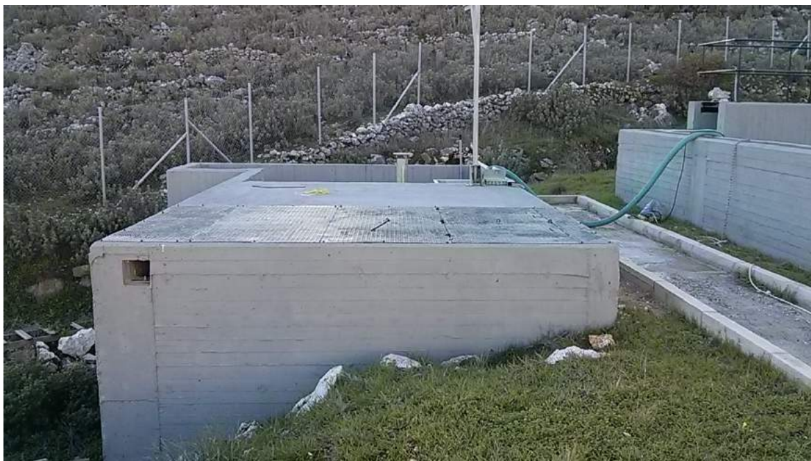
Φωτογραφία 5: Δεξαμενή καθαρών
