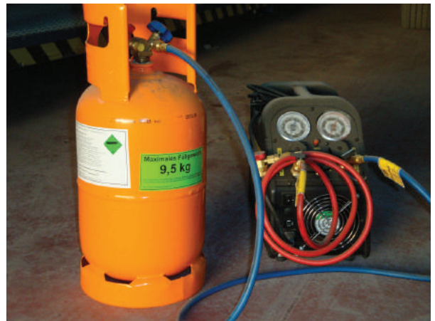
Φωτ. 11 Δοχείο και αντλία αναρρόφησης ψυκτικού μέσου
