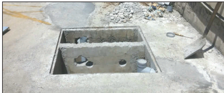
Φωτ. 17 Ο ελαιοδιαχωριστής νερών πλύσης βιομηχανοστασίου κατά την κατασκευή και σήμερα με εμφανή τα δεσμευμένα ελαιώδη
