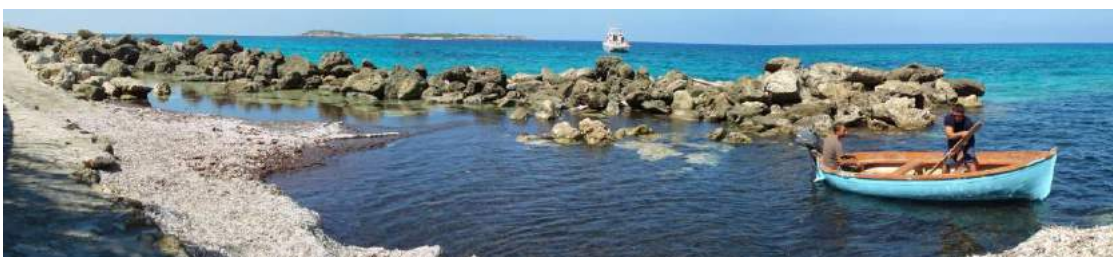
Φώτο Β.5. Άποψη του διασκορπισμένου μώλου προς βορειοδυτικά. Στη φωτογραφία διακρίνονται τα φύκη, φερτά και τα θραύσματα λίθων που έχουν πληρώσει την όπισθεν αυτού λεκάνη (Πηγή: Επίσκεψη μελετητών 10/2010)
