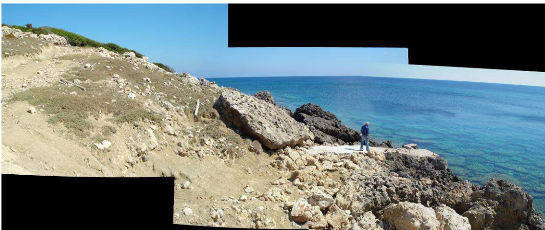
Φώτο Β.6. Άποψη του μικρού προβλήτα στη νότια πλευρά και του μονοπατιού πρόσβασης σε αυτόν. Από τη φωτογραφία είναι εμφανής η ανάγκη ανακατασκευής τόσο του προβλήτα όσο και του μονοπατιού και της αφαίρεσης επισφαλών βραχωδών τεμαχών. (Πηγή: Επίσκεψη μελετητών 10/2010)
