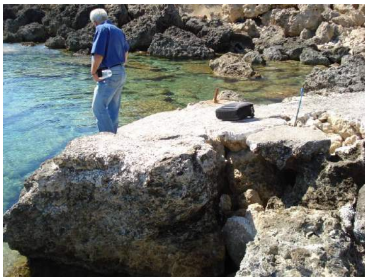
Φώτο Β.7. Άποψη του προβλήτα στη νότιο πλευρά της νήσου Σταμφάνι. Στη φωτογραφία είναι εμφανές ότι το έργο είναι ημικατεστραμμένο και οριακά ευσταθές. Διακρίνεται επίσης και ο λεπτοπλακώδης βραχώδης πυθμένας.
