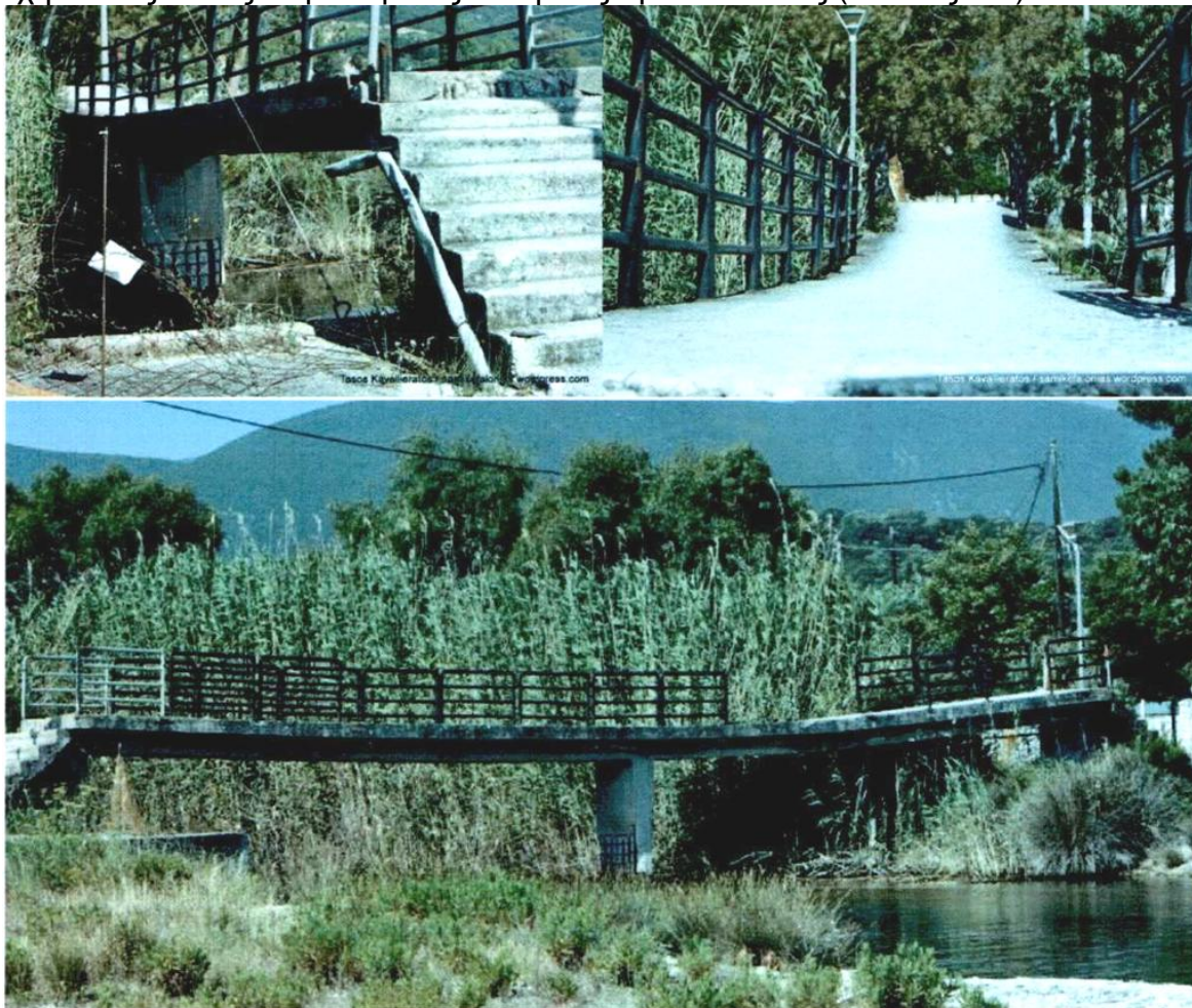
Εικόνες 3-6. Παρούσα Κατάσταση Πεζογέφυρας
