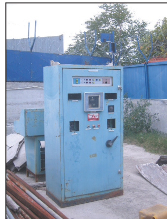
Φωτ. 25 Πάνελ χειρισμού
