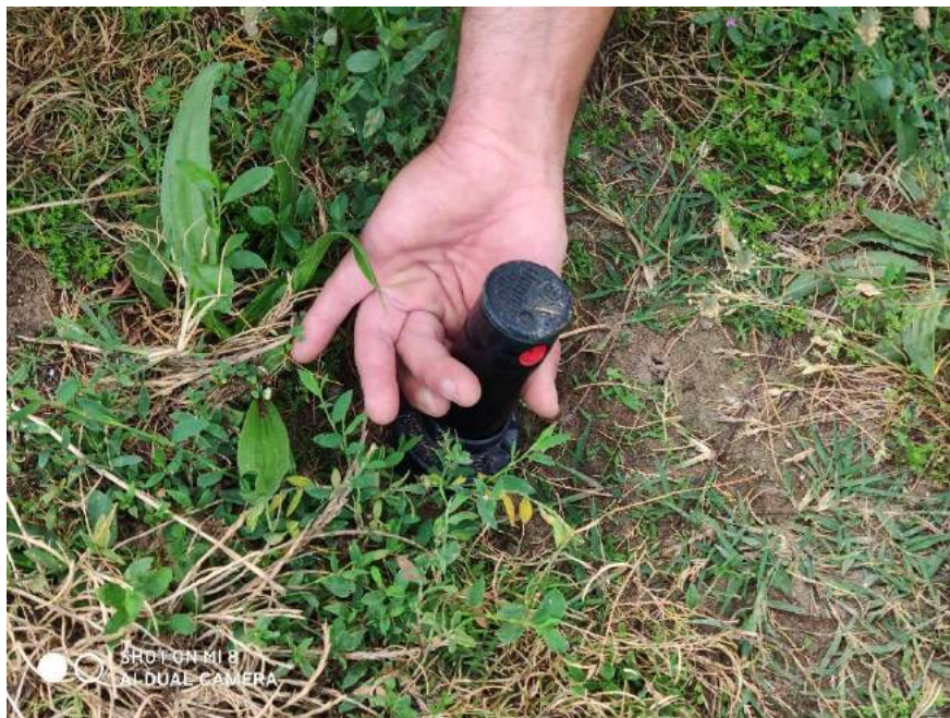
Φώτο 9: Άποψη καταιονιστήρα του υφιστάμενου δικτύου άρδευσης
