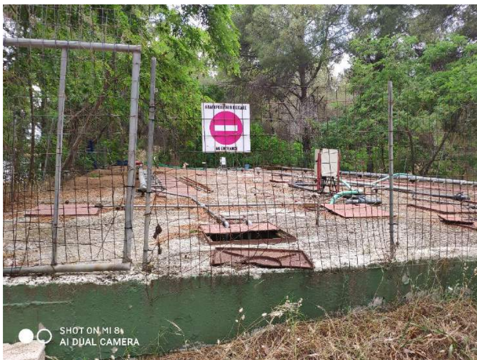
Φώτο 3 Άποψη της περιφραγμένης και με κατάλληλη σήμανση Εγκατάστασης Επεξεργασίας Λυμάτων της Ξενοδοχειακής Μονάδας
