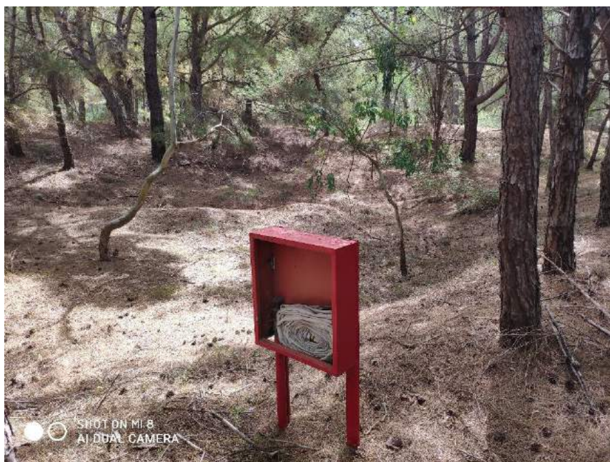
Φώτο 7: Τμήμα του δικτύου πυρόσβεσης του γηπέδου
