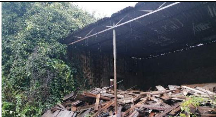
Φωτογραφία 14-7 Άποψη του ερειπωμένου κτιρίου 3 εντός της Ζώνης II του ΕΣΧΑΔΑ
