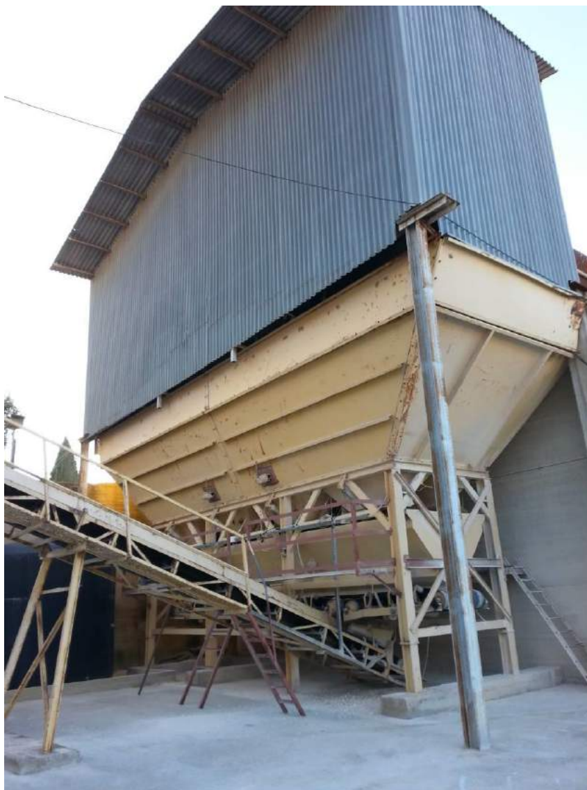
Εικόνα 14.6: Άποψη σιλό και μεταφορικής ταινίας αδρανών υλικών
