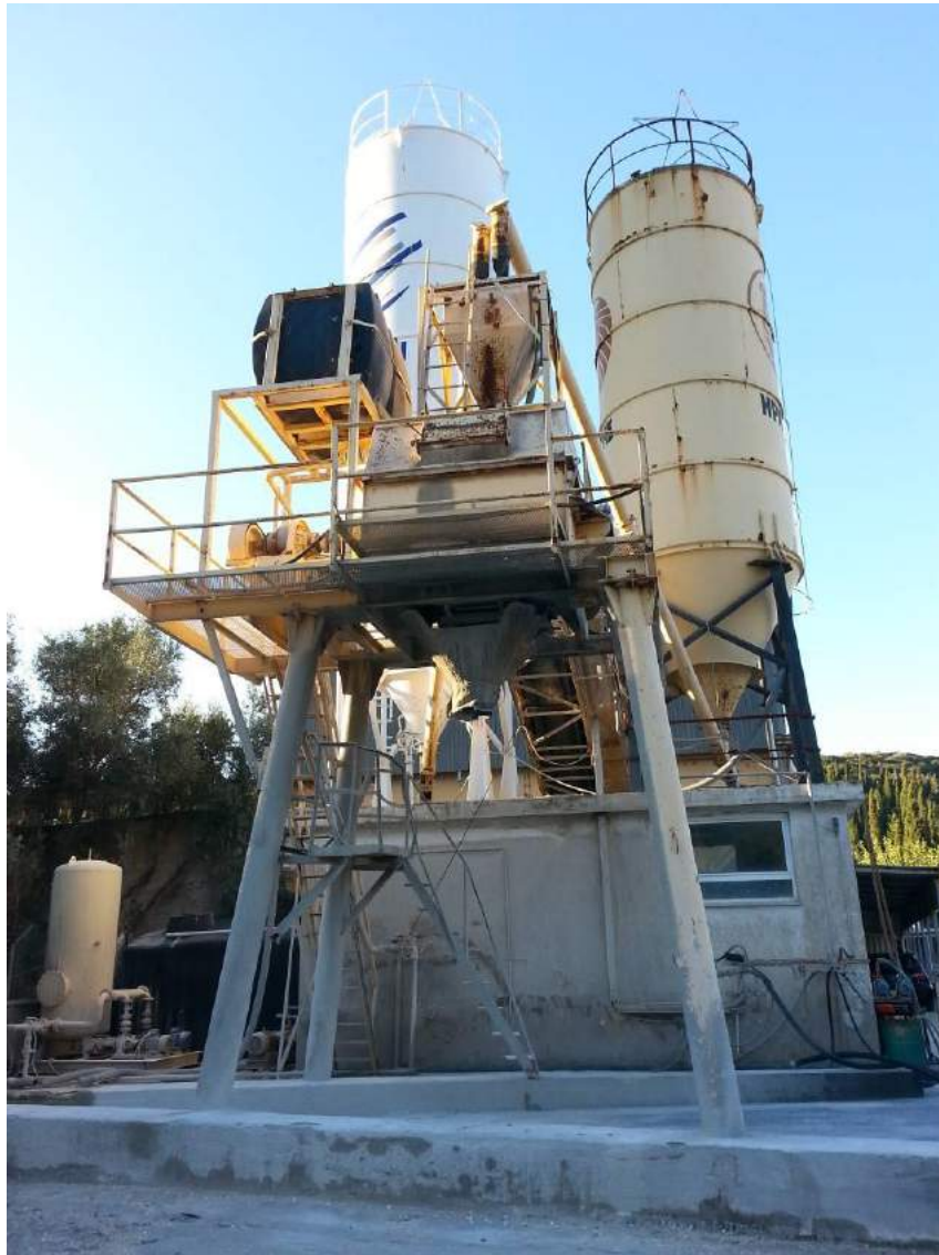
Εικόνα 14.9: Άποψη αναμκτήρα σκυροδέματος και θέσης φόρτωσης οχημάτων μεταφοράς έτοιμου σκυροδέματος
