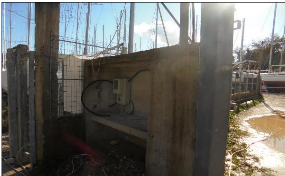
Εικόνα 40. Παροχή ηλεκτρικού ρεύματος στην είσοδο του Ναυπηγείου
