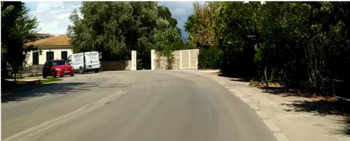
Άποψη της κλειστής καμπύλης περί τη ΧΘ 1+450 με διαπιστωμένες εκτροπές οχημάτων στη κατεύθυνση προς Λευκάδα, διακρίνεται στο βάθος το στηθαίο ασφαλείας.
