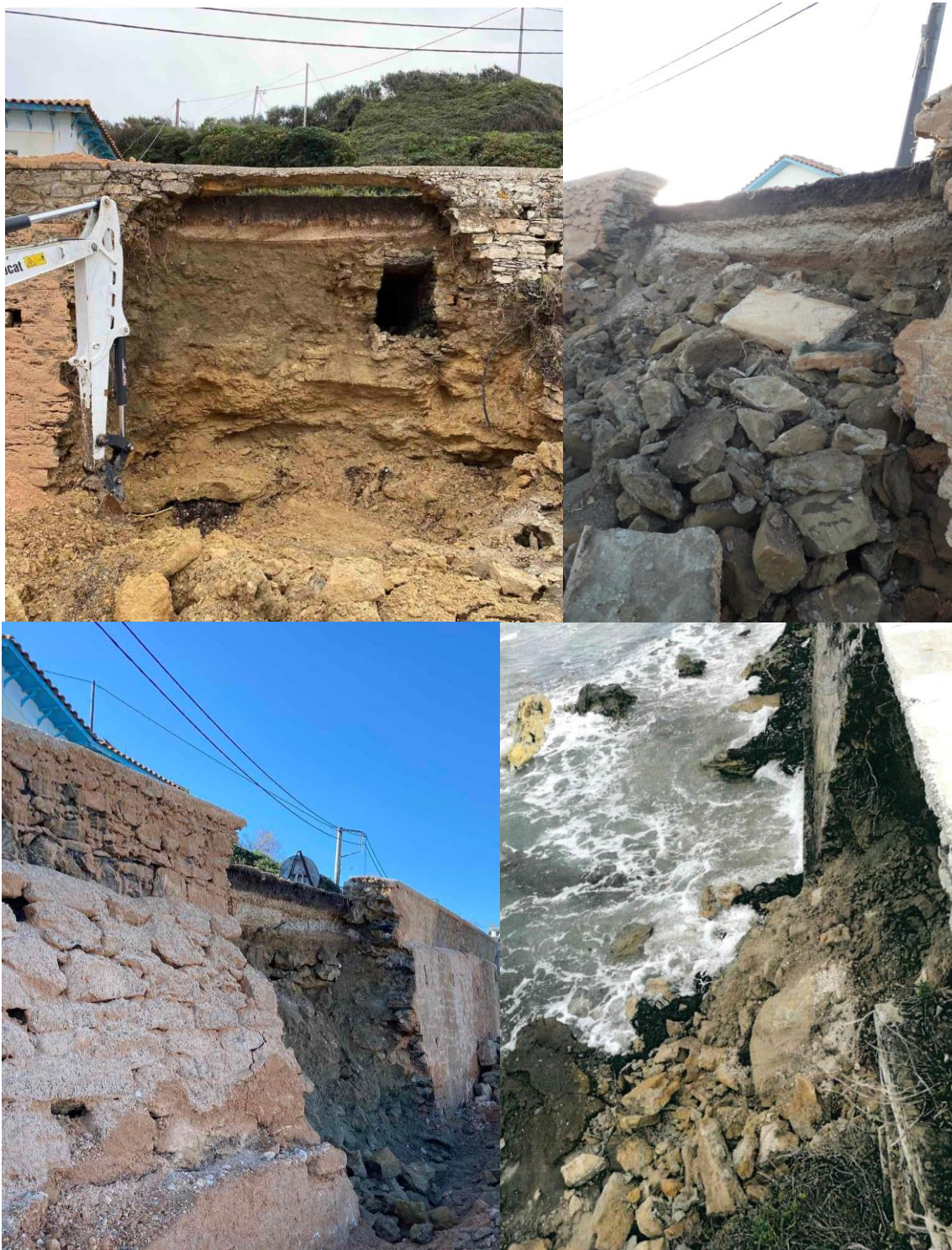
Εικόνα 2. Τμήματα τοιχίου που κατέρρευσαν.
