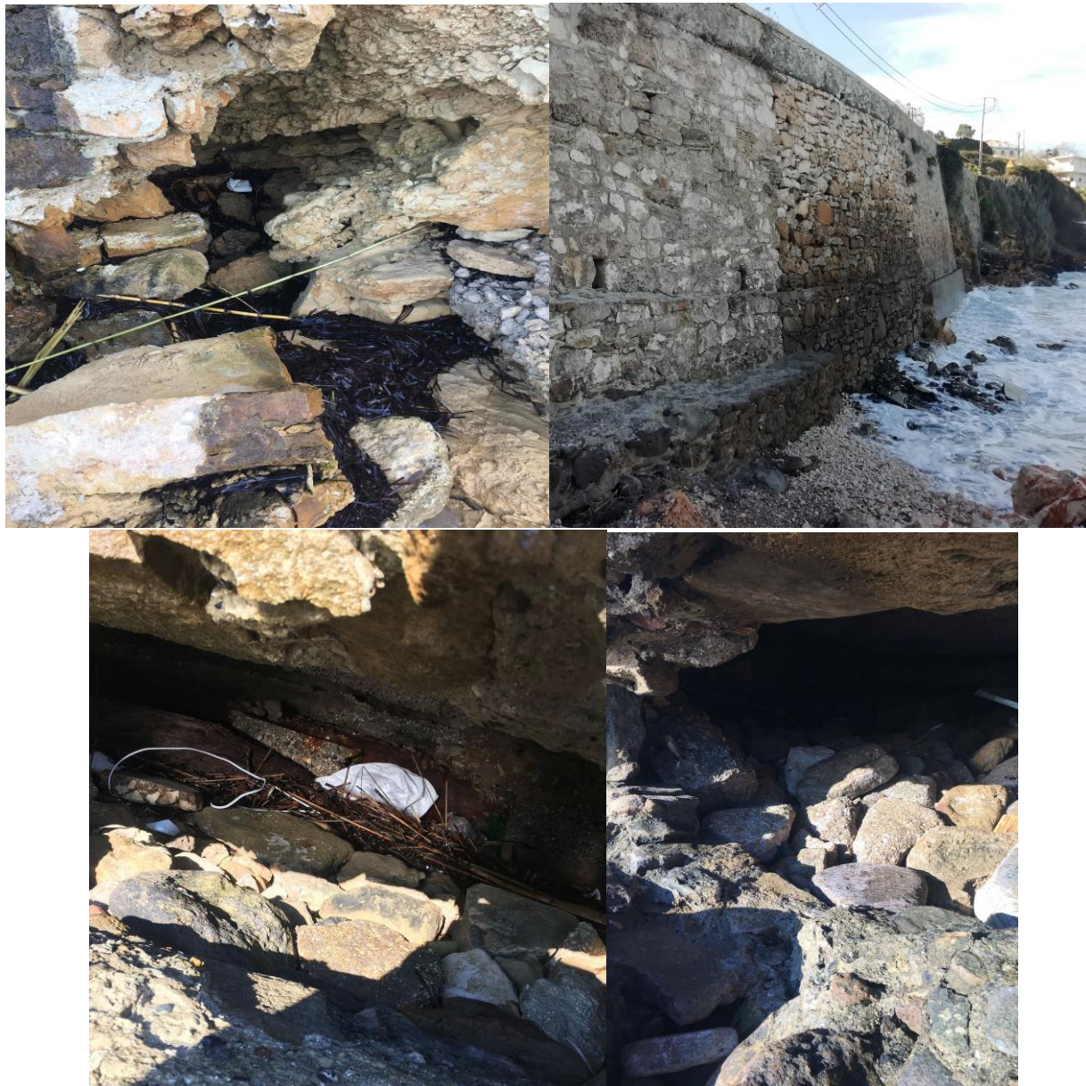
Εικόνα 1. Τμήματα όπου παρατηρήθηκε υποσκαφή βάσης τοιχίου.
