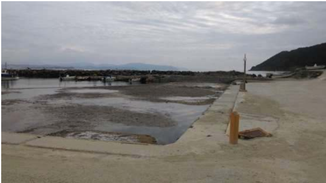
Φωτογραφία 10: Προσάμμωση και προσφύκωση της εσωτερικής λιμενολεκάνης – παραλιακά κρηπιδώματα (2015).
