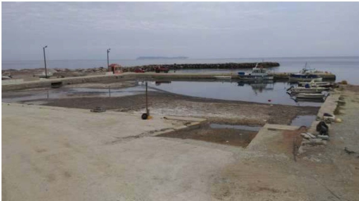
Φωτογραφία 12: Προσάμμωση και προσφύκωση της εσωτερικής λιμενολεκάνης – γενική όψη (2015).
