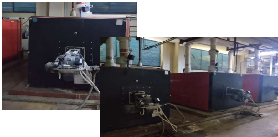
Εικόνα 1: Απεικόνιση των ατμογεννητριών και μέρους του μηχανοστασίου /λεβητοστασίου
