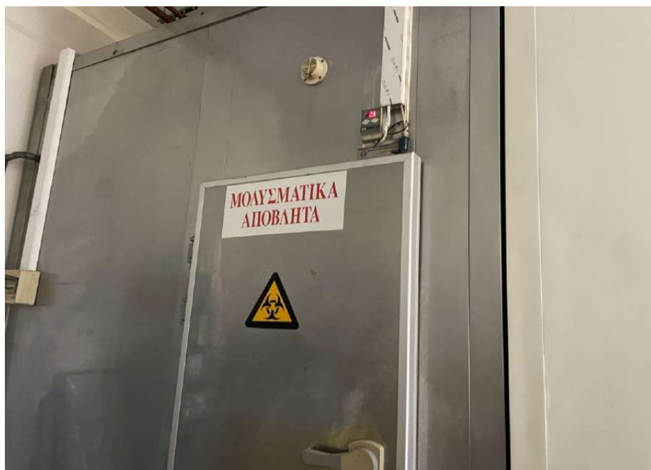
Εικόνα 4: Ψυκτικός θάλαμος προσωρινής αποθήκευσης αποβλήτων του Γενικού Νοσοκομείου Κέρκυρας
