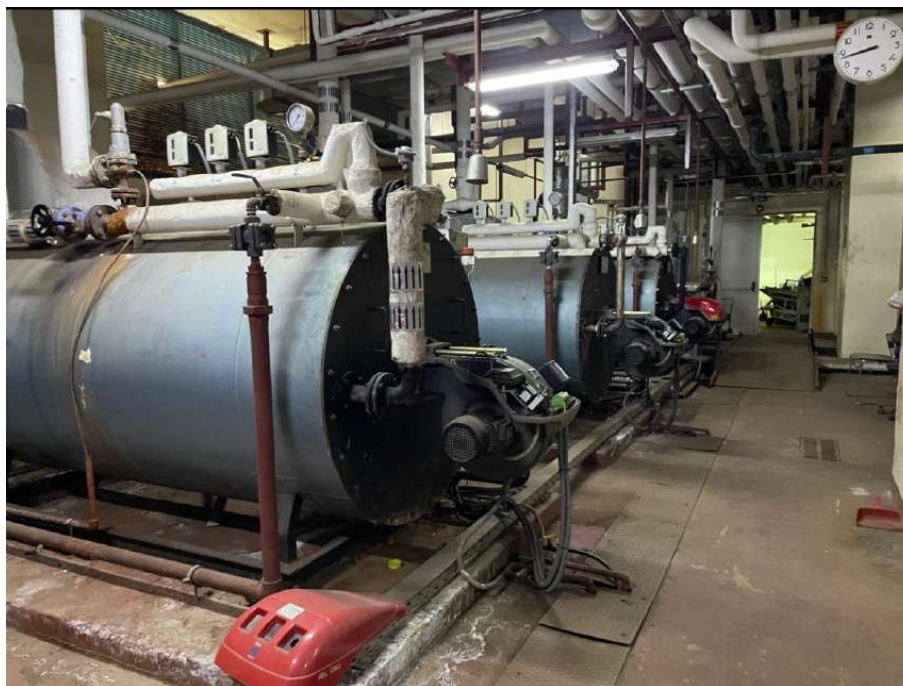
Εικόνα 8: οι λέβητες παραγωγής ζεστού νερού
