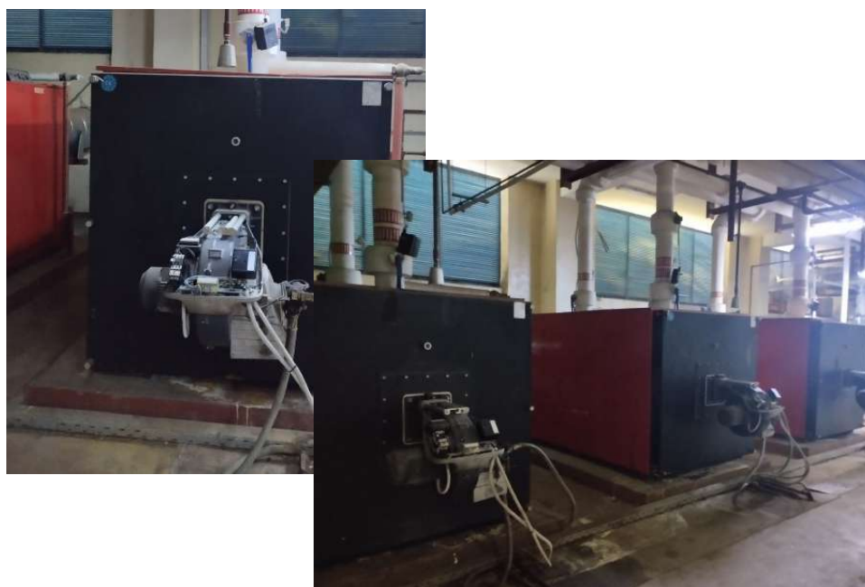
Εικόνα 7: Απεικόνιση των ατμογεννητριών και μέρους του μηχανοστασίου/λεβητοστασίου
