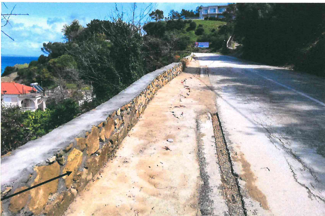
Άποψη της υφιστάμενης οδού προς Αγούλου. Διακρίνεται στην αρχή το πρόσφατα ανακατασκευασμένο τμήμα του λιθόκτιστου τοίχου το οποίο κατασκευάστηκε μετά την αστοχία του προϋπάρχοντος
