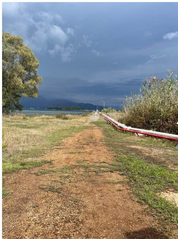
Φωτογραφία 10: Αγωγοί μεταφοράς καυσίμων (λευκό χρώμα) και αγωγός πυρόσβεσης (κόκκινο χρώμα)
