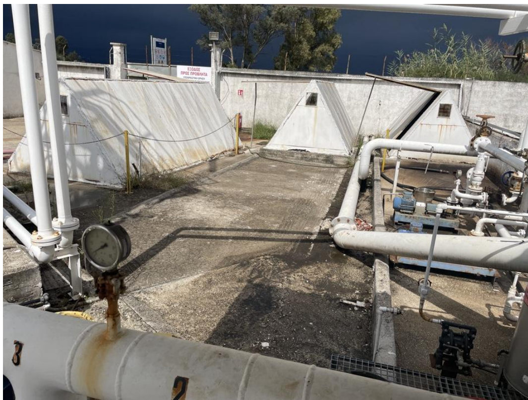
Φωτογραφία 9: Υφιστάμενη Μονάδα Επεξεργασίας Υγρών Αποβλήτων (Μ.Ε.Υ.Α.)
