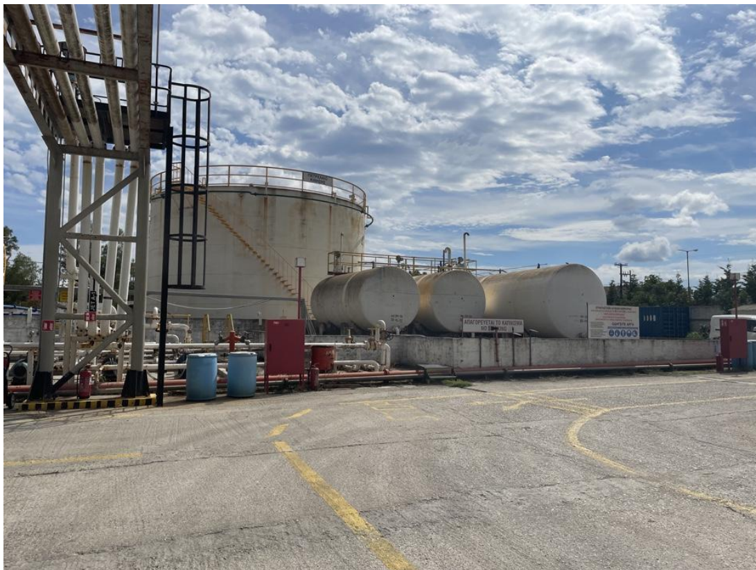
Φωτογραφία 3: Άποψη υπαίθριων οριζόντιων και κατακόρυφων κυλινδρικών δεξαμενών αποθήκευσης υγρών καυσίμων
