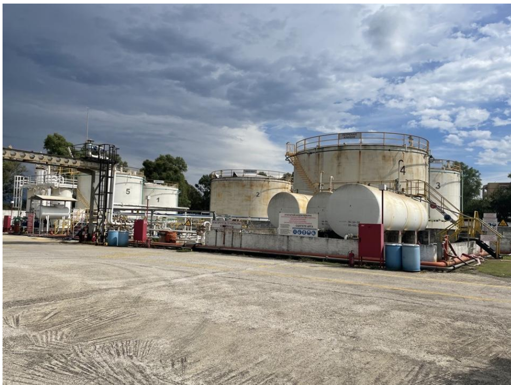
Φωτογραφία 2: Άποψη υπαίθριων κατακόρυφων κυλινδρικών δεξαμενών αποθήκευσης υγρών καυσίμων
