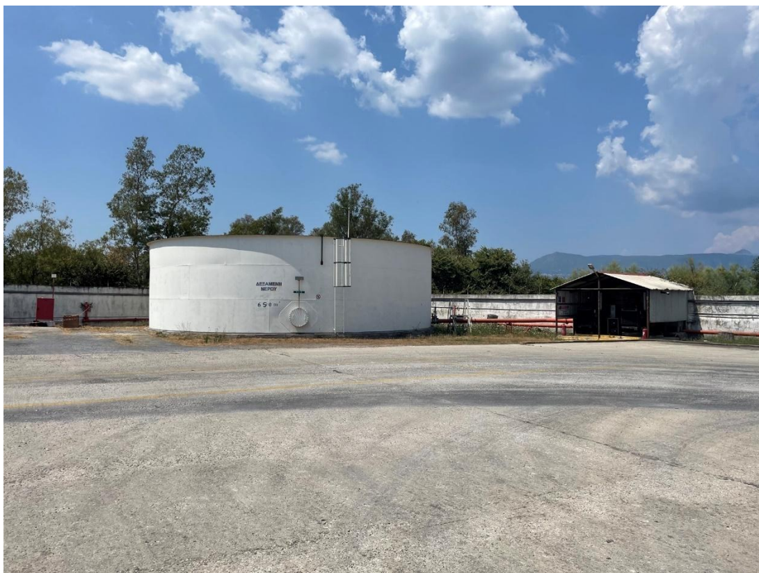
Φωτογραφία 5: Άποψη δεξαμενής νερού πυρόσβεσης
