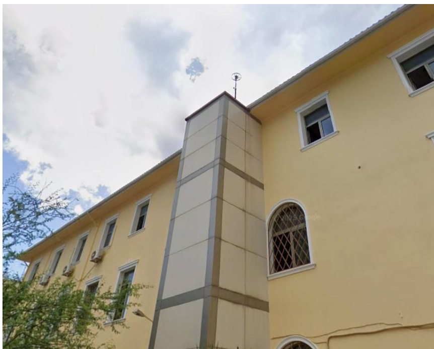
Εικόνα 1. Σημερινή κατάσταση ανελκυστήρα στο Κτίριο Διοικητηρίου Π.Ε. Ζακύνθου.
