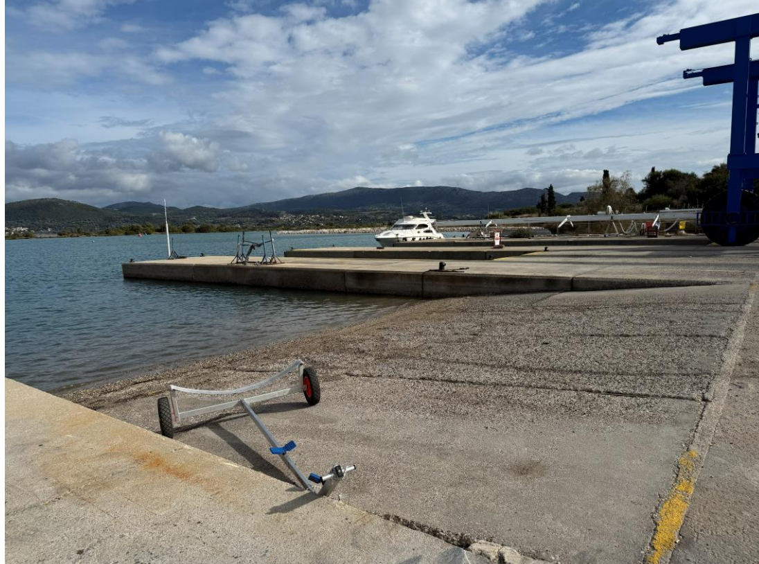
Φωτογραφία 18: Ράμπα ανέλκυσης / καθέλκυσης σκαφών και νηοδόχοι εξυπηρέτησης των ανυψωτικών μηχανημάτων travelifts προ του χώρου χειραίας απόθεσης και συντήρησης σκαφών.
